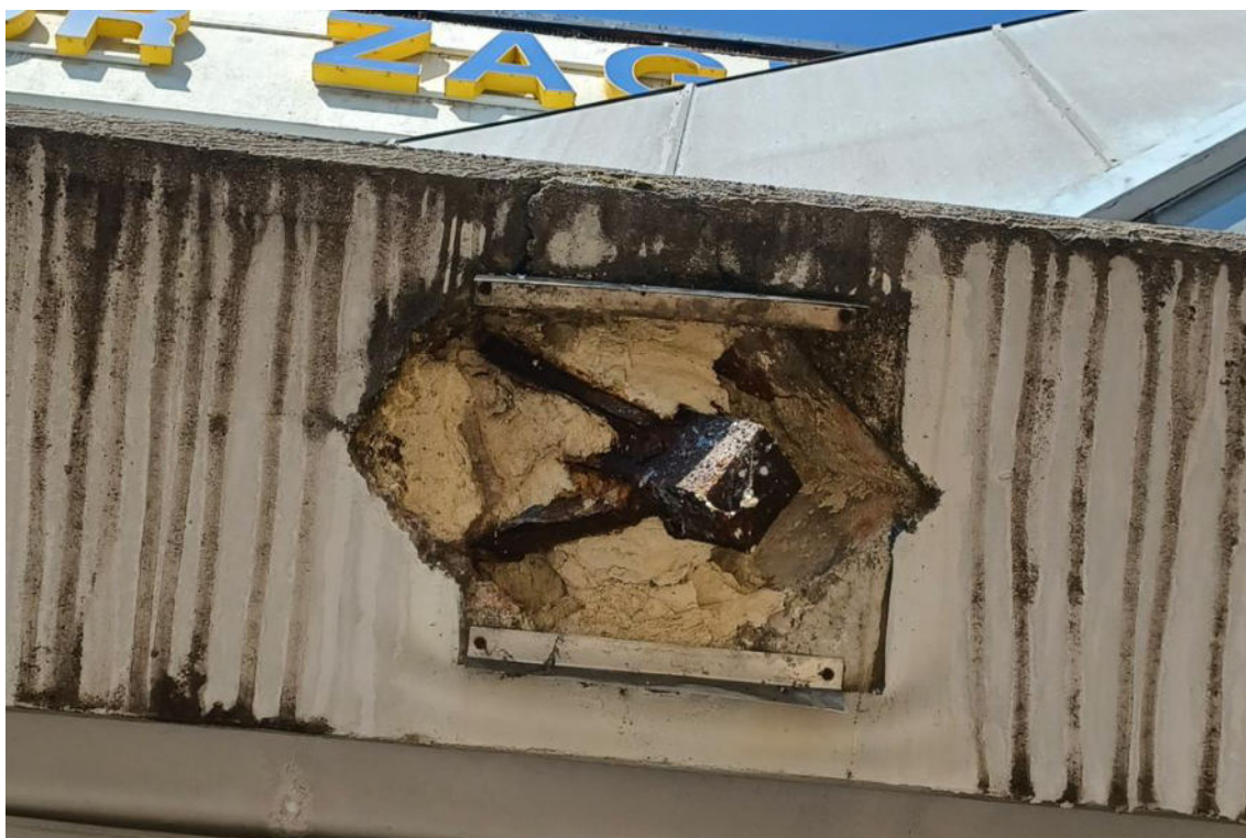
24 Korozija spojeva čeličnih profila-zatega i betonske nadstrešnice na Aveniji Marina Držića
