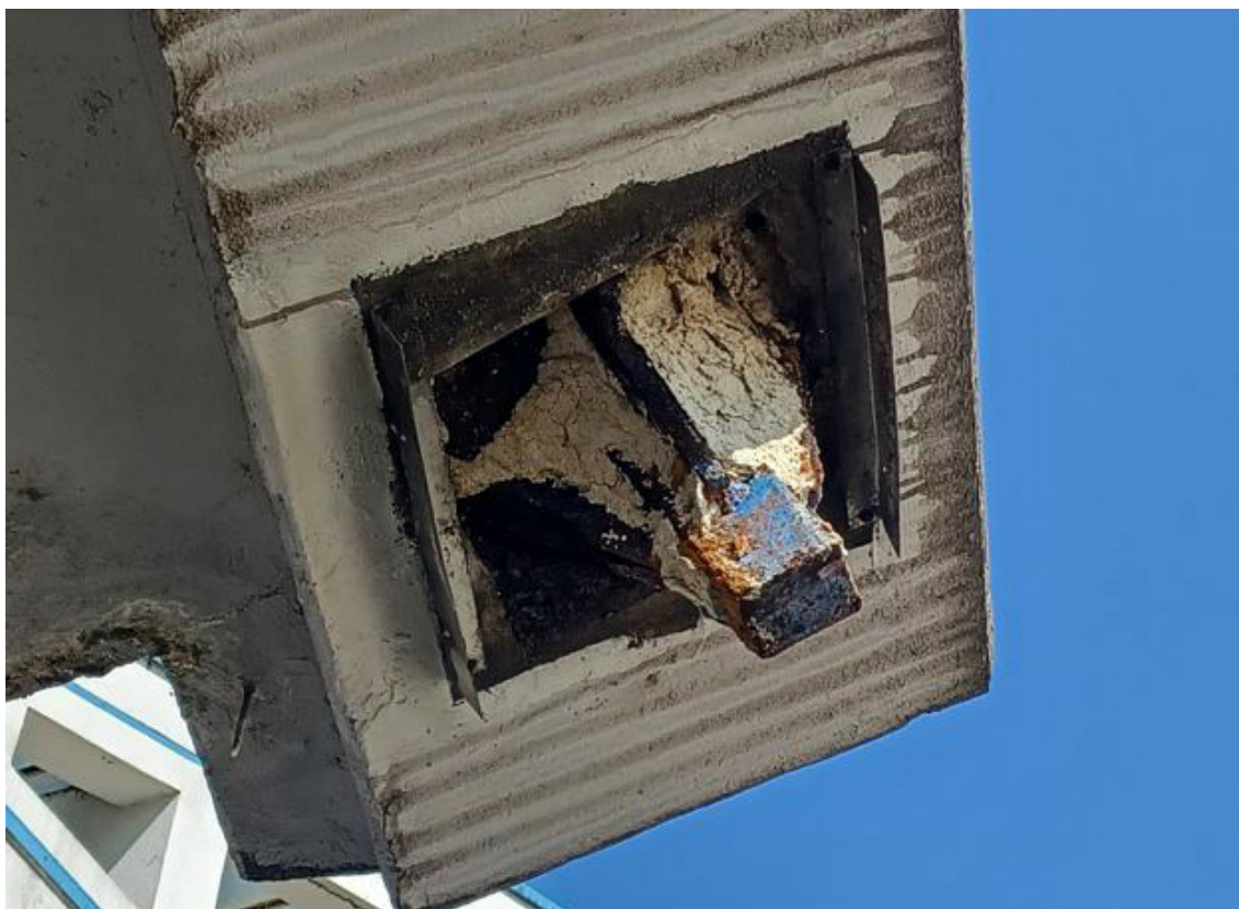
25 Korozija spojeva čeličnih profila-zatega i betonske nadstrešnice na Aveniji Marina Držića
