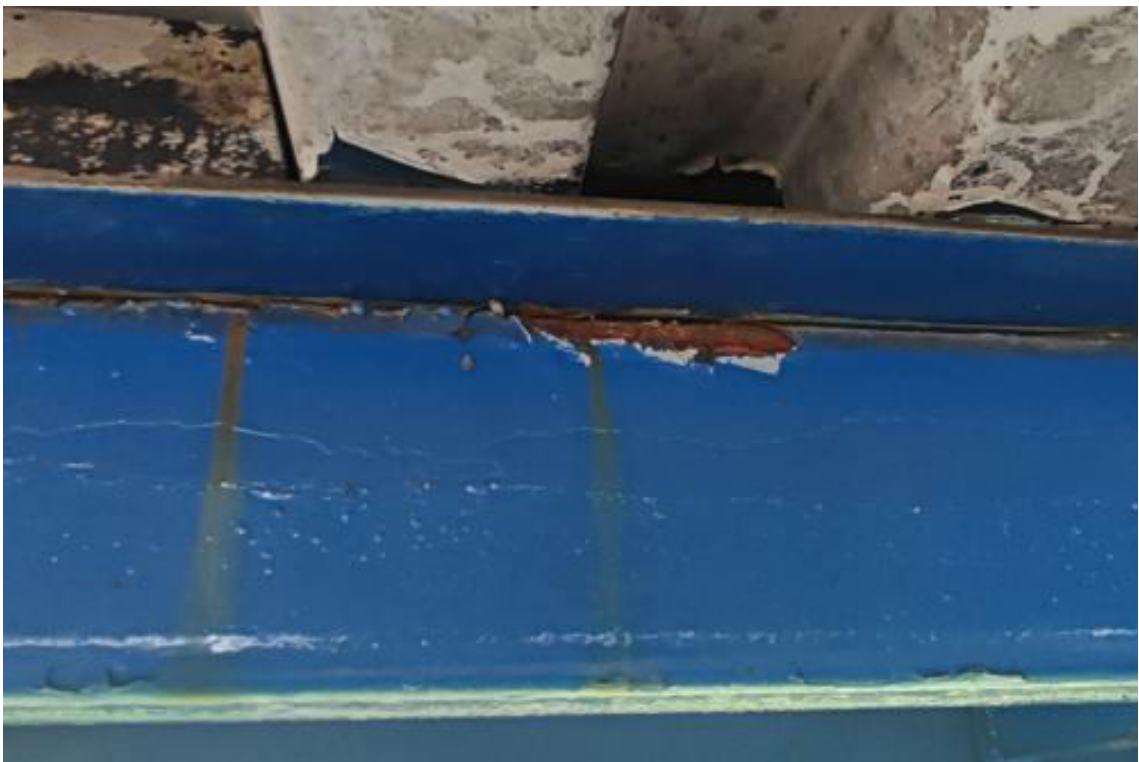
Slika 10 Oštećenja (korozija) nastala uslijed prodora atmosferilija
