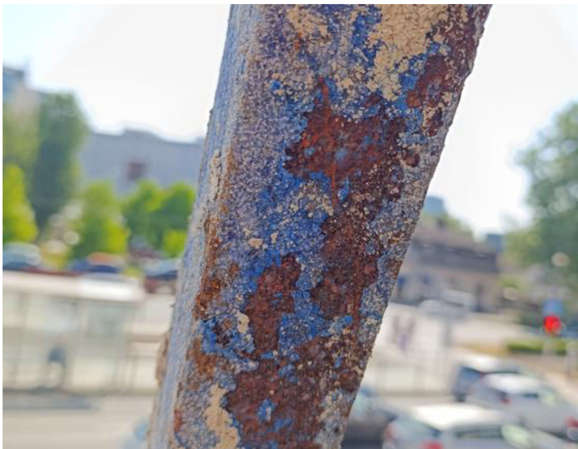
Slika 22 Korozija čeličnih profila-zatega nadstrešnice na Aveniji Marina Držića
