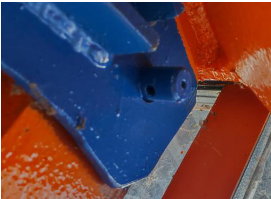
Slika 20 Ispao je dio spoja (trna) elementa – pozicija: čekaonica 1. kat Slika
