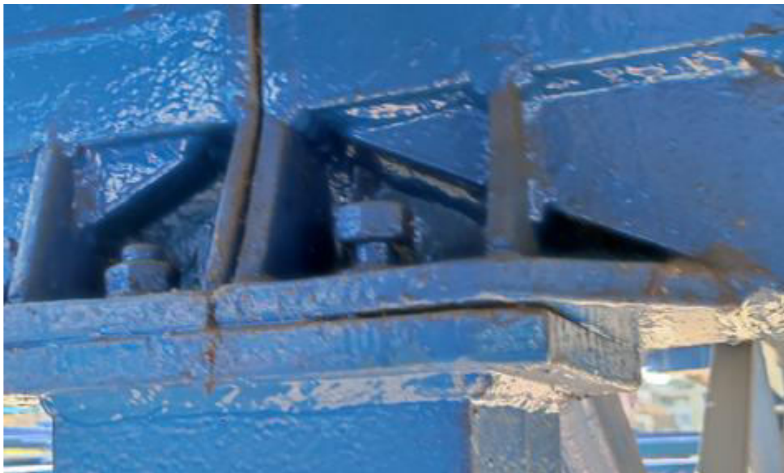
Slika 7 Otpušteni vijak spoja stupa i rešetke potrebno je zategnuti
