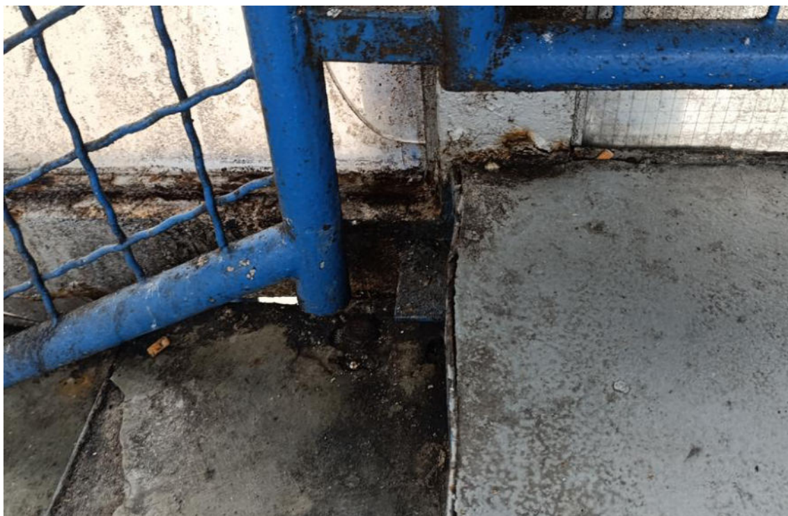
Slika 17 Dotrajalost završnog sloja stepenica i hodne staze, korozija čeličnih elemenata – pozicija: nathodnik
