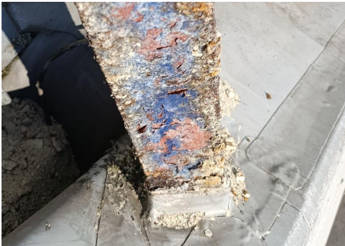
Slika 21 Korozija čeličnih profila-zatega nadstrešnice na Aveniji Marina Držića
