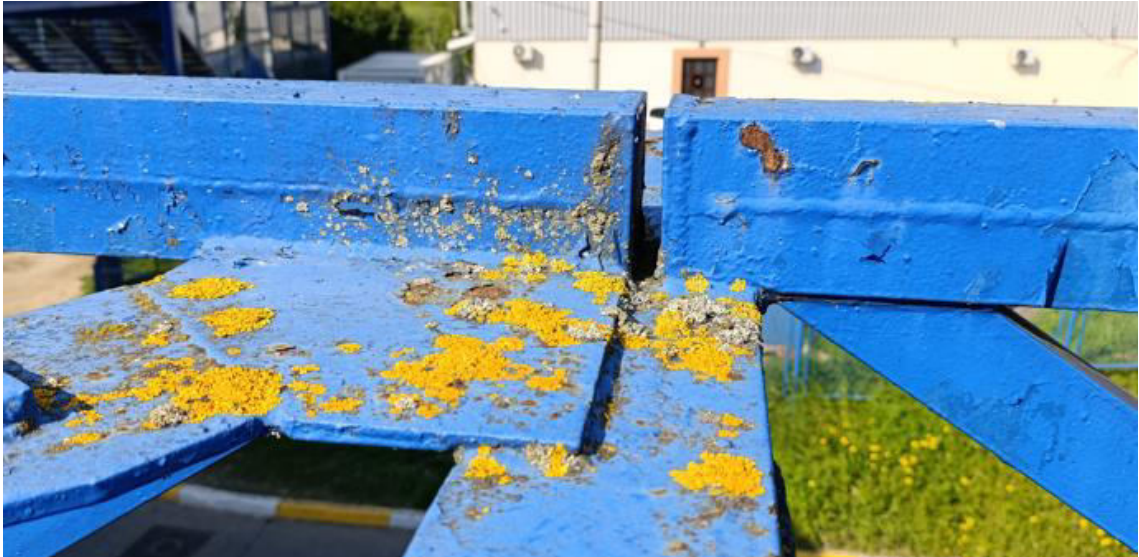
Slika 3 Oštećenja (korozija) nastala uslijed izloženosti dijelova konstrukcije atmosferilija
