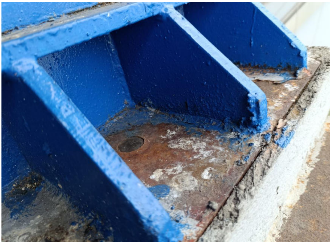
Slika 13 Korozija čelične pločice – pozicija: sjeverno pročelje čekaonice na katu
