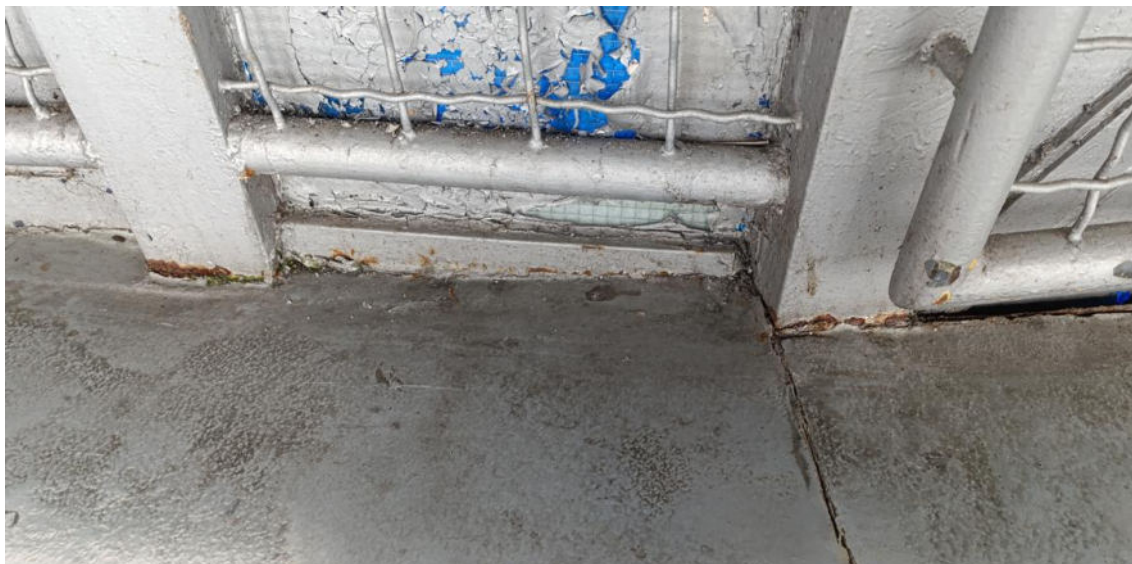
Slika 19 Dotrajalost završnog sloja stepenica i hodne staze i korozija čeličnih elemenata – pozicija: nathodnik
