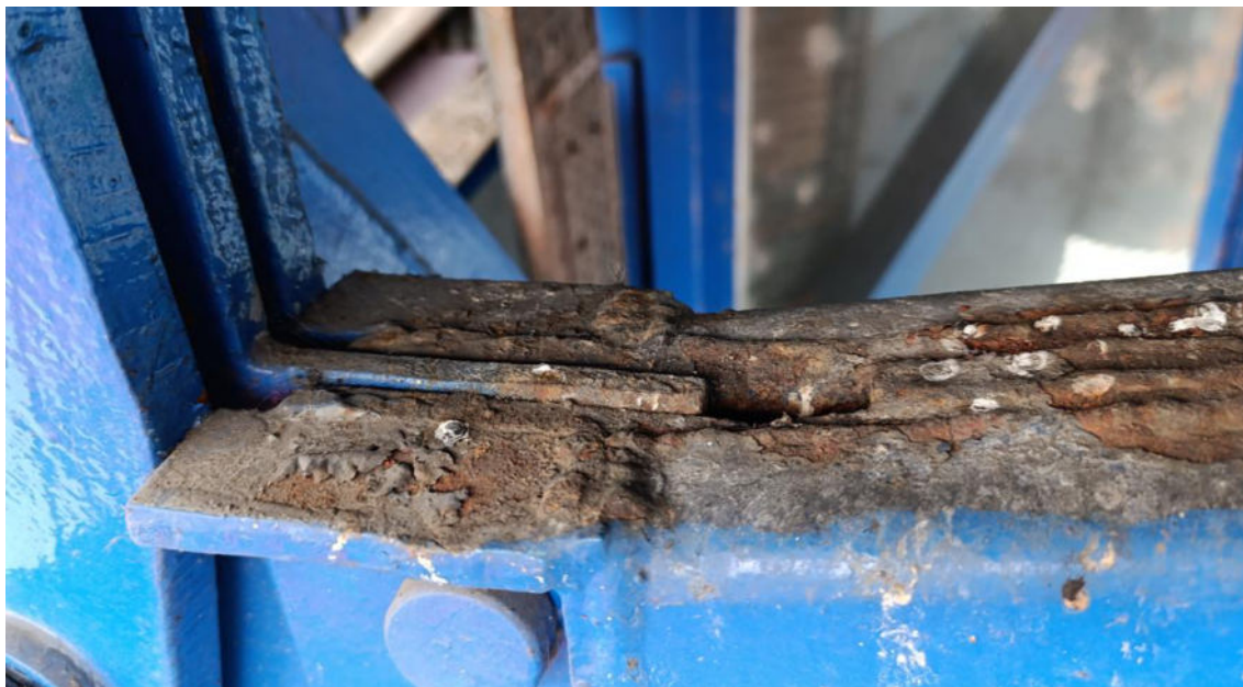
Slika 11 Vidljiva korozija – pozicija: sjeverno pročelje čekaonice na katu
