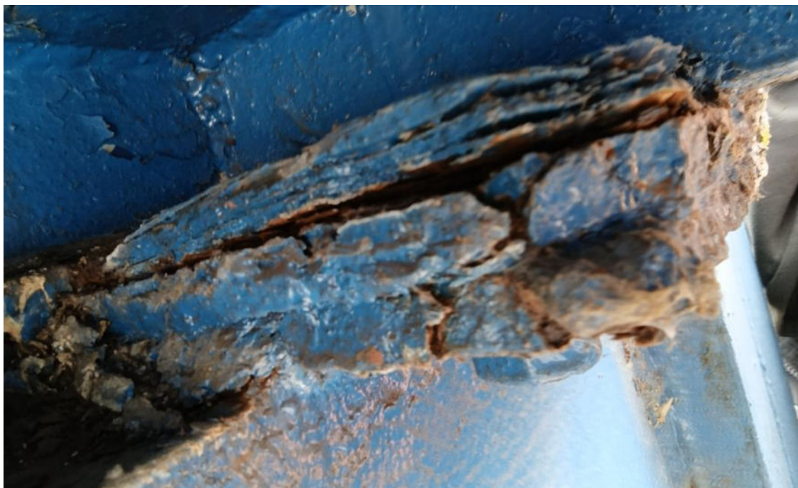
Slika 6 Oštećenja (korozija) nastala uslijed izloženosti dijelova konstrukcije atmosferilija – pozicija: podgled nathodnika
