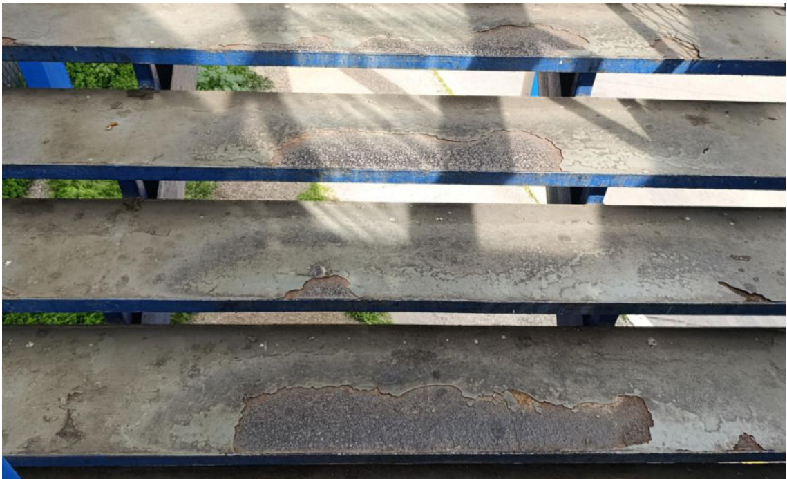
Slika 16 Dotrajalost završnog sloja stepenica i hodne staze i korozija čeličnih elemenata – pozicija: nathodnik
