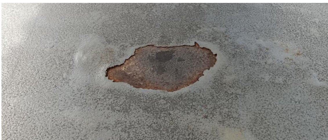
Slika 18 Dotrajalost završnog sloja stepenica i hodne staze i korozija čeličnih elemenata – pozicija: nathodnik
