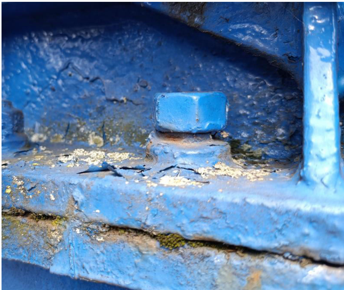
Slika 5 Otpušteni vijak spoja stupa i rešetke potrebno je zategnuti
