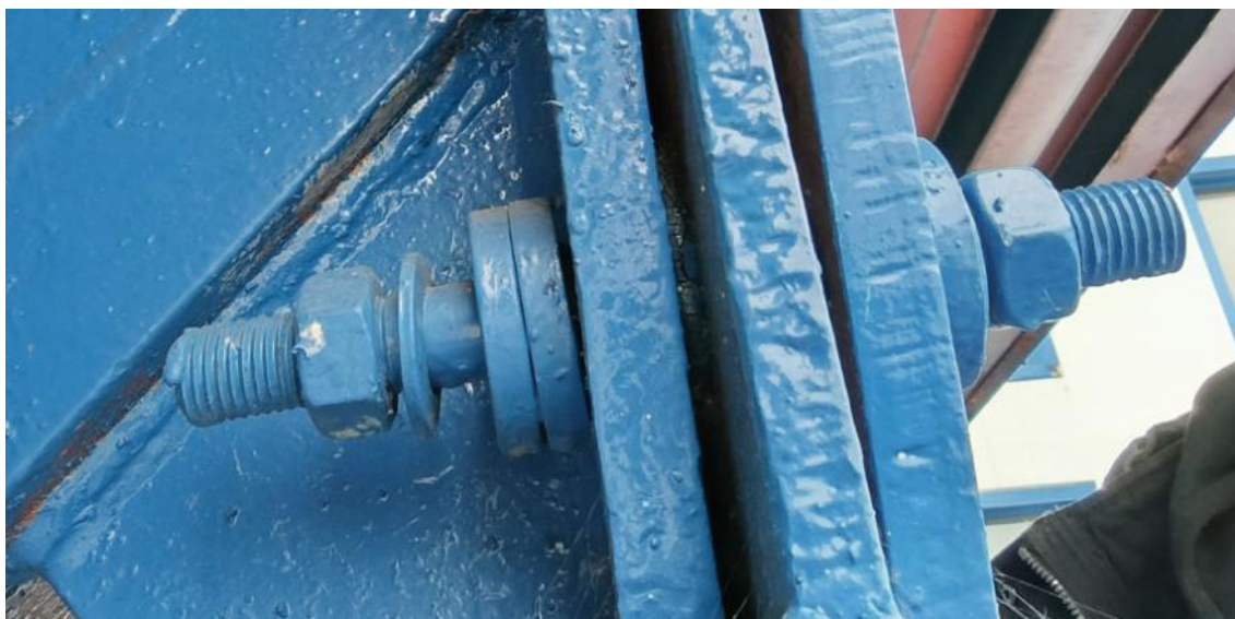
Slika 14 Otpušteni vijak potrebno je zategnuti - pozicija: sjeverno pročelje čekaonice na katu
