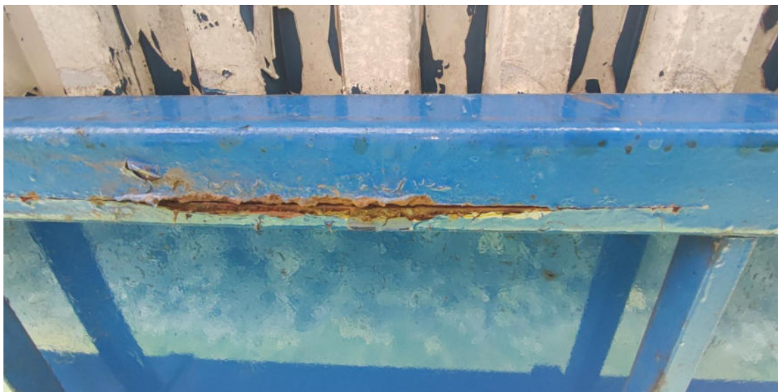
Slika 8 Oštećenja (korozija) nastala uslijed prodora atmosferilija i širenja unutar elemenata
