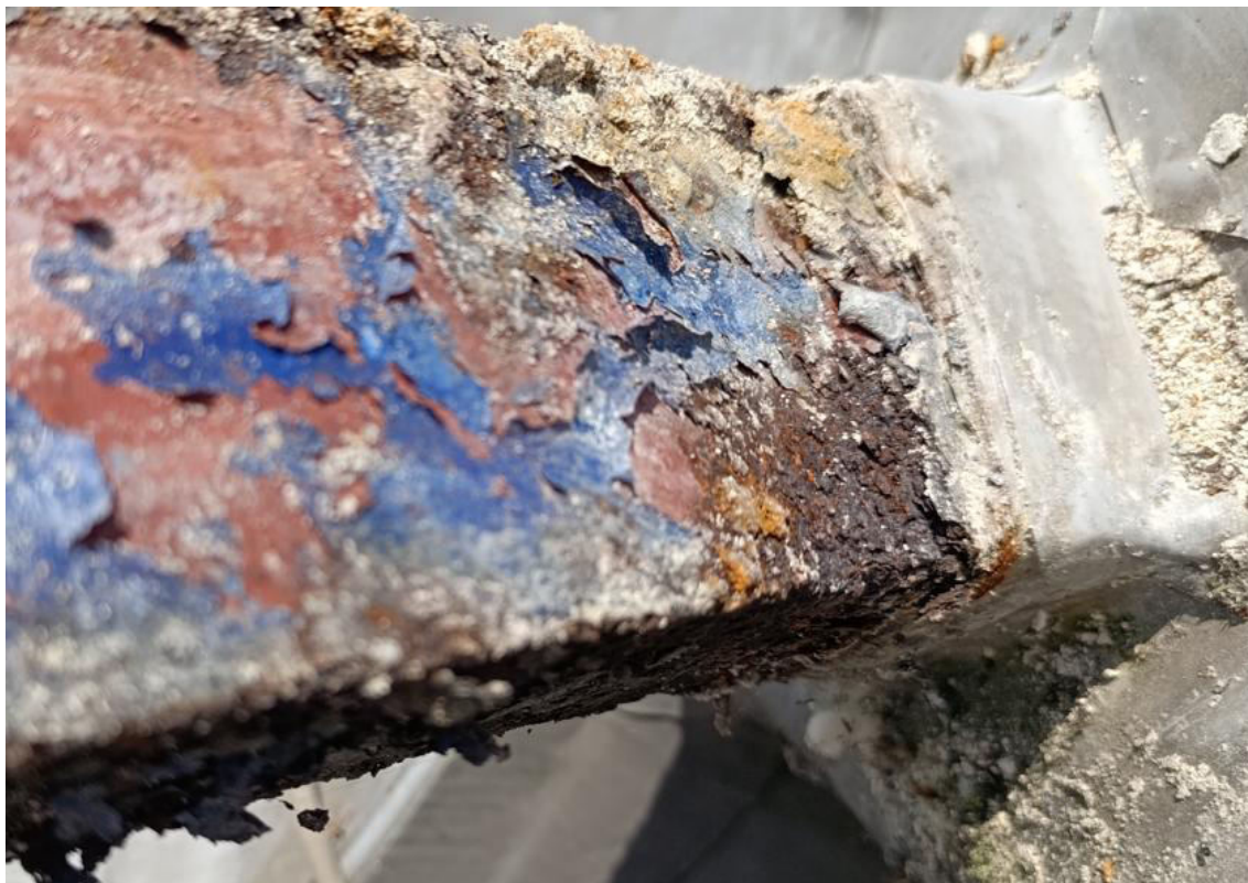
23 Korozija čeličnih profila-zatega nadstrešnice na Aveniji Marina Držića
