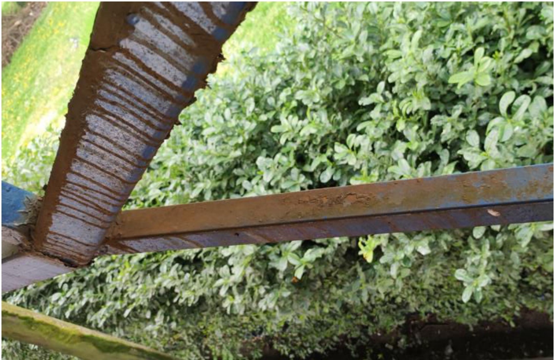
Slika 9 Oštećenja (korozija) nastala uslijed prodora atmosferilija i širenja unutar elemenata
